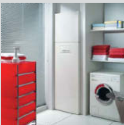
Udobje ogrevanja in tople sanitarne vode na najmanjšem prostoru
